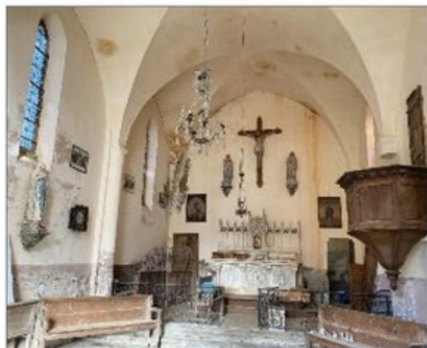
L'église de Boussac, propriété de la commune de Saint-Affrique, est victime d'infiltrations.
